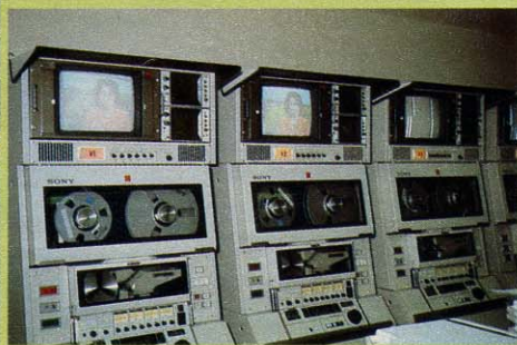
◆最新の設備を備えた放送局。制作棟で収録された授業（テレビ番組、ラジオ番組）は、ここから東京タワーへ送られ、各地に電波で放送される。まさに放送大学の中核といったところで、電子ロックの扉を開けて中へ入る。
